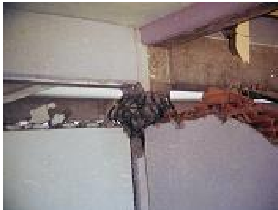
Figura 11. Falla en columna corta del Liceo Raimundo Martínez Centeno. (Cortesía de E. Castilla)
