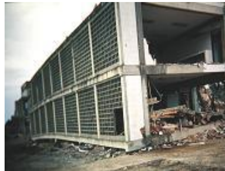
b) Después del terremoto; aplastamiento del primer entresijo (Cortesía de E. Castilla)
