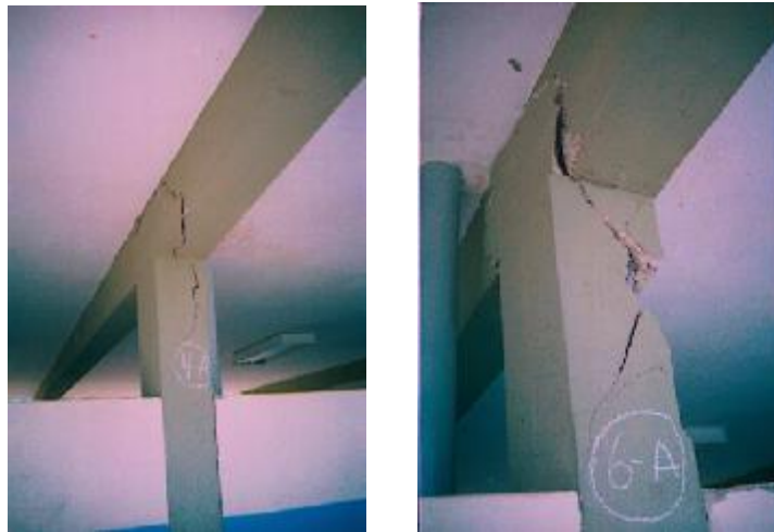
b) Fallas en columnas cortas
